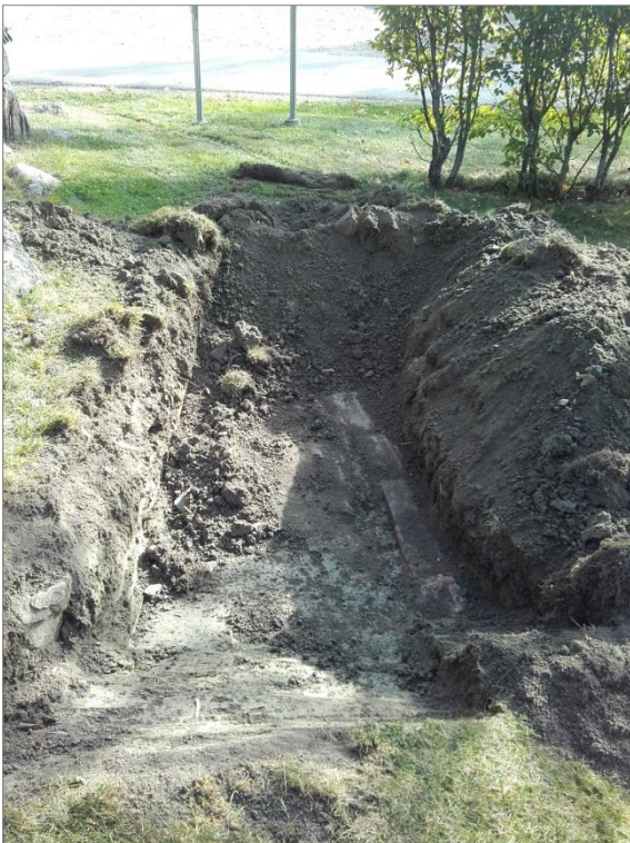
Figur 15. Schakt för plåt på klockstapelns västra sida. Här framkom i schaktens botten en rad med tegelstenar som sannolikt ligger ovan en äldre elledning. Foto mot S.
