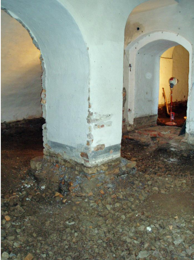
Figur 37. Rum 225/226 efter det att golvfyllningen tagits ut. Som synes låg det tidigare golvet nästan direkt an mot åsgruset.
