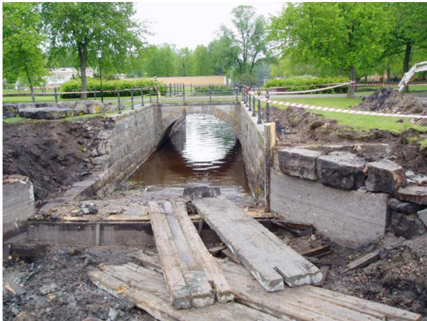
Figur 10. Schaktningar på norra sidan av övre dammen. Här syns att vissa partier av stenvallen tillfälligt tagits bort vid arbetet. Foto från söder .
