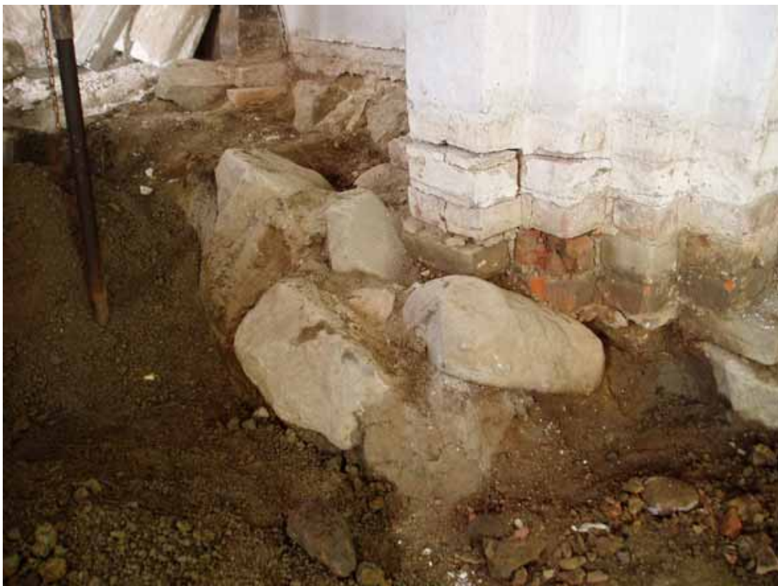
Figur 23. Skadat pelarfundament i norra långväggen. Förutom de uppenbara skadorna på teglet i själva pelaren syns det tydligt hur stenarna tryckts upp och ut.
