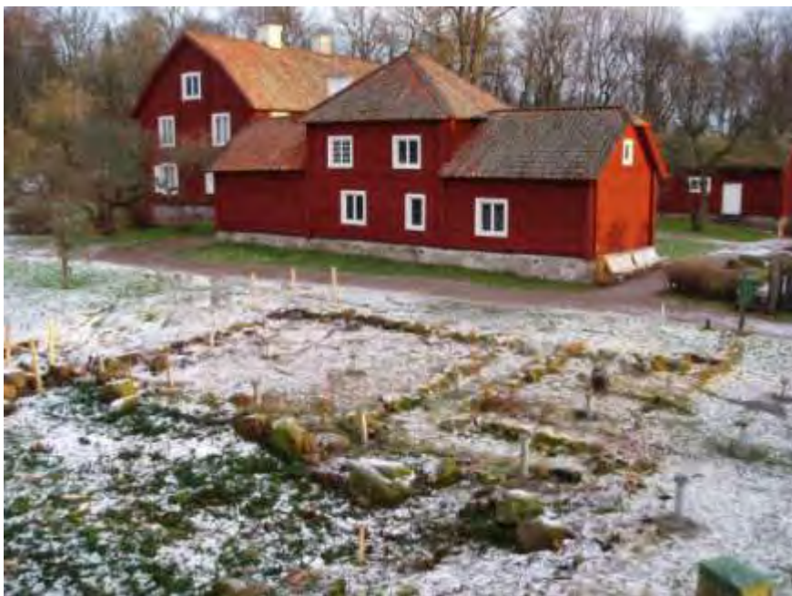
Figur 10. Översikt av platsen för den nya servicebyggnaden strax efter det att plintarna satts på plats (jmf fig 11).
