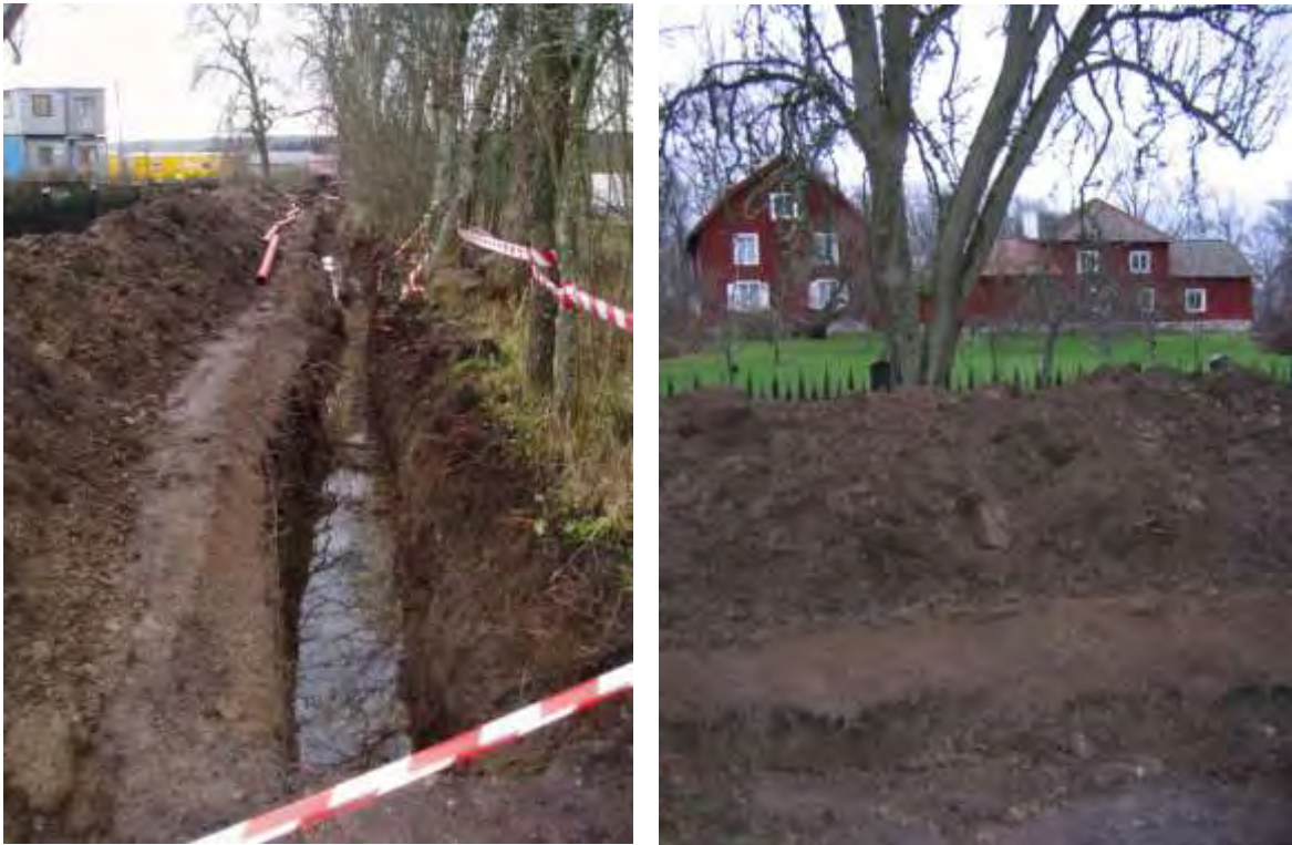
Figur 8-9. Schaktet för vatten och avlopp. Den vänstra bilden visar schaktet sett från norr medan den högra bilden visar schaktet från väster med den nya trädgården och huvudbyggnaderna i bakgrunden. Foto Bent Syse och Joakim Kjellberg (t.v), Upplandsmuseet.
