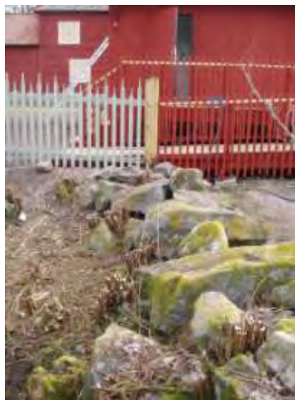
Figur 17 t.v. och 18 t.h. Den vänstra bilden visar den bevarade stenmuren innan rampen anslutit mot marken och den högra efter avslutat arbete.
