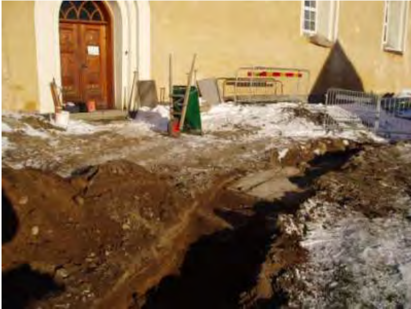
Figur 12. Översikt av ledningsschaktet med kyrkan i bakgrunden, från sydväst. De flata stenhällarna som troligen utgjort golvyta i vapenhuset syns mitt i bilden.
