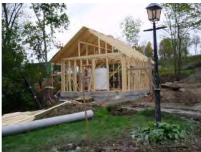
Figur 3. Stommen till RWC uppförd och större delen av ledningsschakten runt byggnaden är gjorda.
