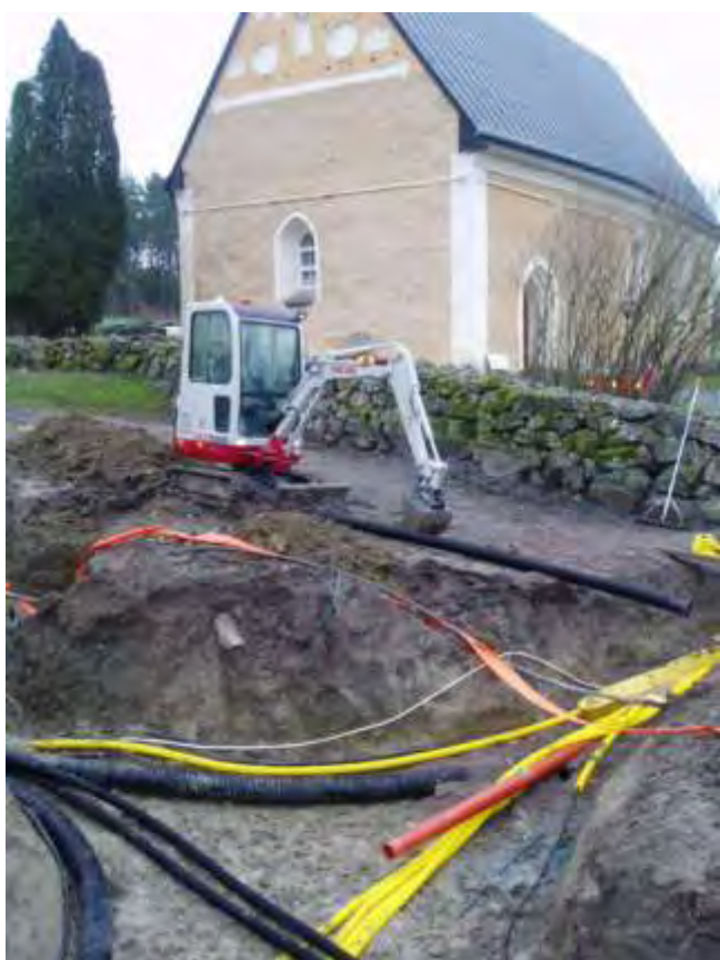
Figur 4. Strax sydost om RWC möttes ett större antal ledningar av olika slag.
