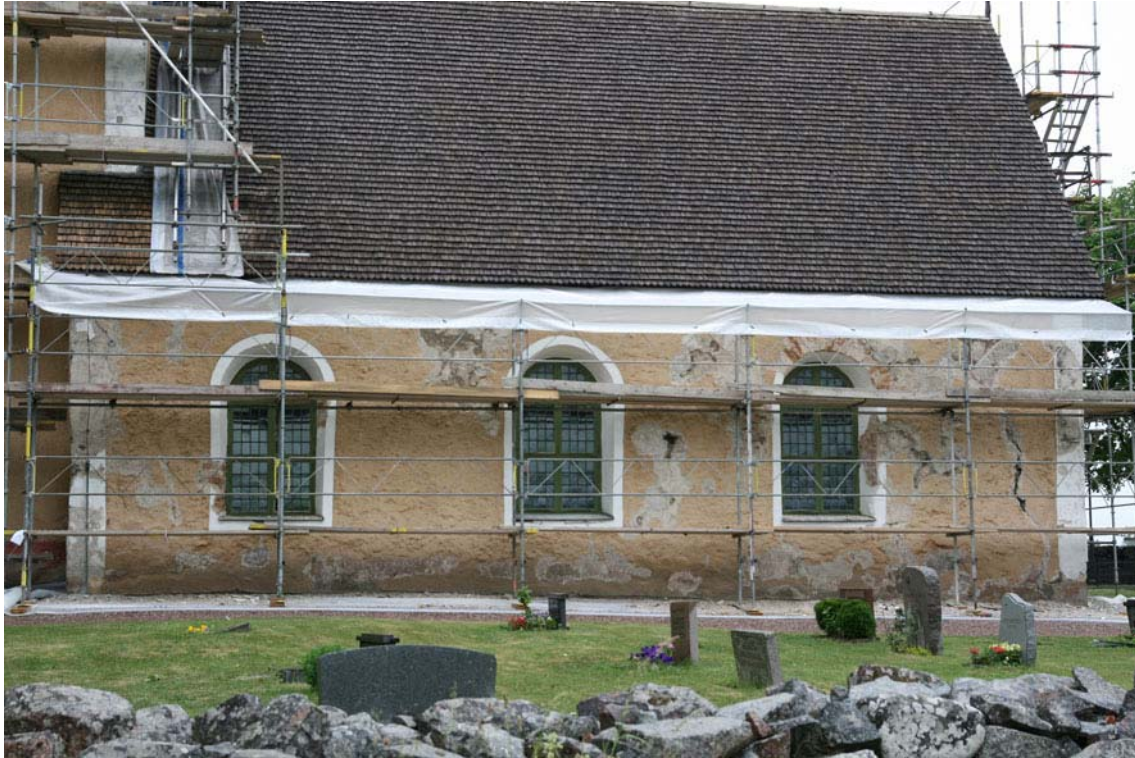
Södra fasaden sedan löst sittande puts huggits ner och sprickor huggits upp. Nära hörnet till höger fanns en större spricka i murverket.
