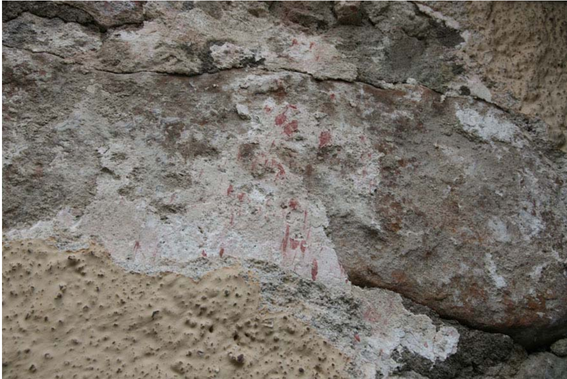
När lös puts huggits bort kunde denna rosafärgade slätputs med röda färgstänk dokumenteras på östra korgaveln. Putsen kan vara från 1600 eller 1700-talet.
