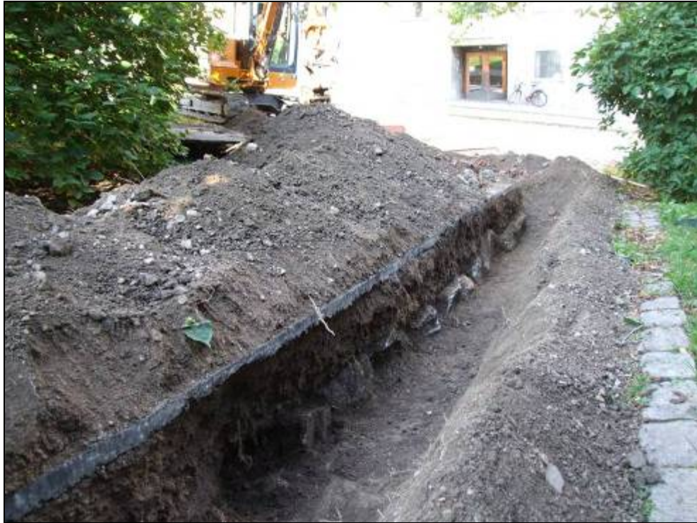
Figur 51. Schakt 10 med i sektionen synlig syllstensrad efter byggnad med möjlig datering till 1500-1600 tal. I bakgrunden ses S:t Olofsgatan. Foto mot nordväst, Anna Ölund, Upplandsmuseet.
