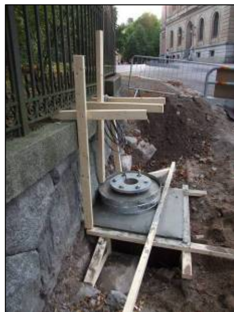
Figur 22. Istället för att ta bort en del av muren fästes belysningsstolpens fundament i den. Fundamentet fästes genom nedborrade armeringsjärn och en över dessa gjuten betongplatta med infästning för stolpen. Foto mot sydväst. Anna Ölund, Upplandsmuseet.
