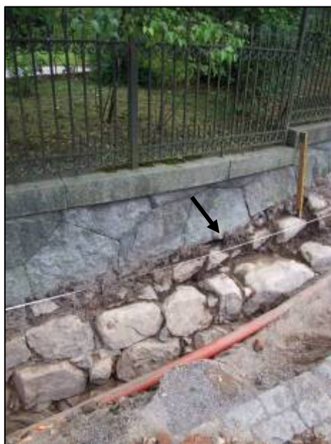
Figur 21. Nuvarande ärkebiskopsgårdens terrasseringsmur som byggts på muren till Ärkebiskopsborgen. Pilen markerar fundamentets tänkta placering. Fotot taget mot söder av Anna Ölund, Upplandsmuseet.
