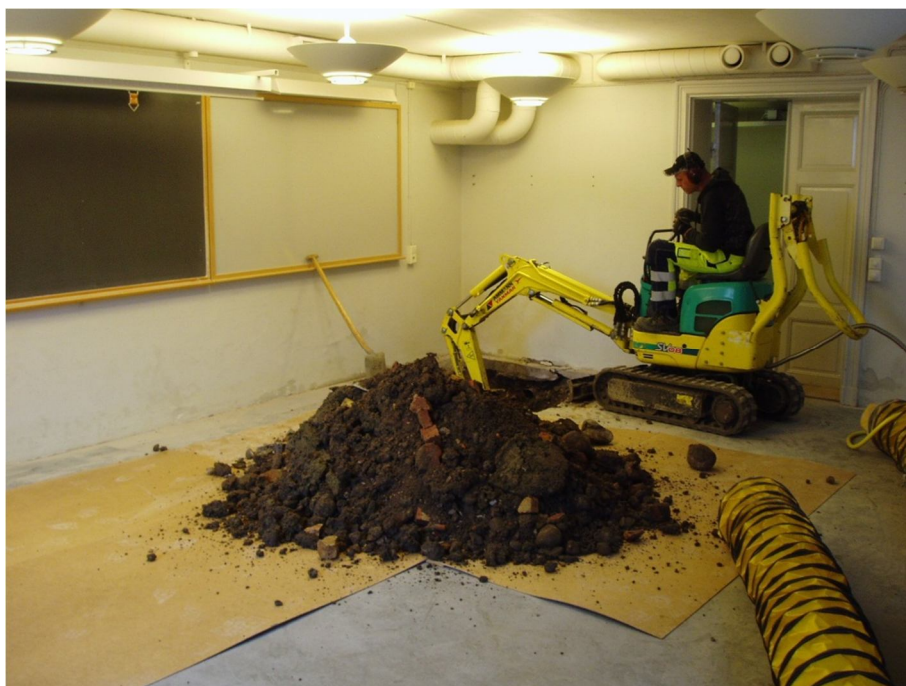
Figur 31. En liten grävare tog sig in i källaren och schaktade ur grop F. Foto 2011-09-06, mot sydost.
