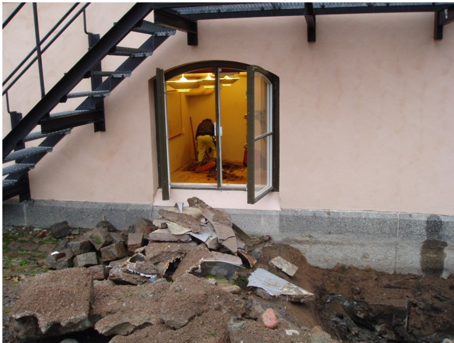
Figur 30. Betonggolvet i rummet bilades bort innan gropen kunde schaktas ur. Foto 2011-09-06, mot sydost.
