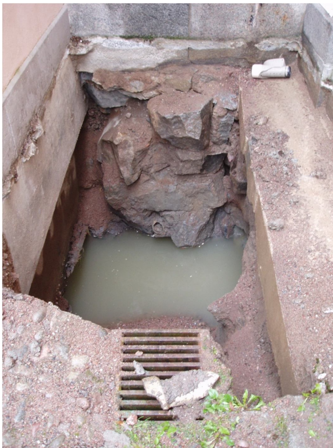
Figur 27. Grop E, urschaktad. Till vänster syns grunden för hisschaktet och i bakgrunden den kraftiga grundmuren till länkbyggnaden. Även denna grop vattenfylldes snabbt. Foto 2011-09-06, mot sydost.
