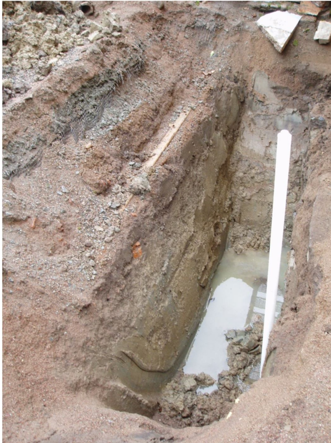
Figur 22. Västra sidan av grop D. Mitt på denna sida har sektionen ritats. Foto 2011-09-06, mot norr.
