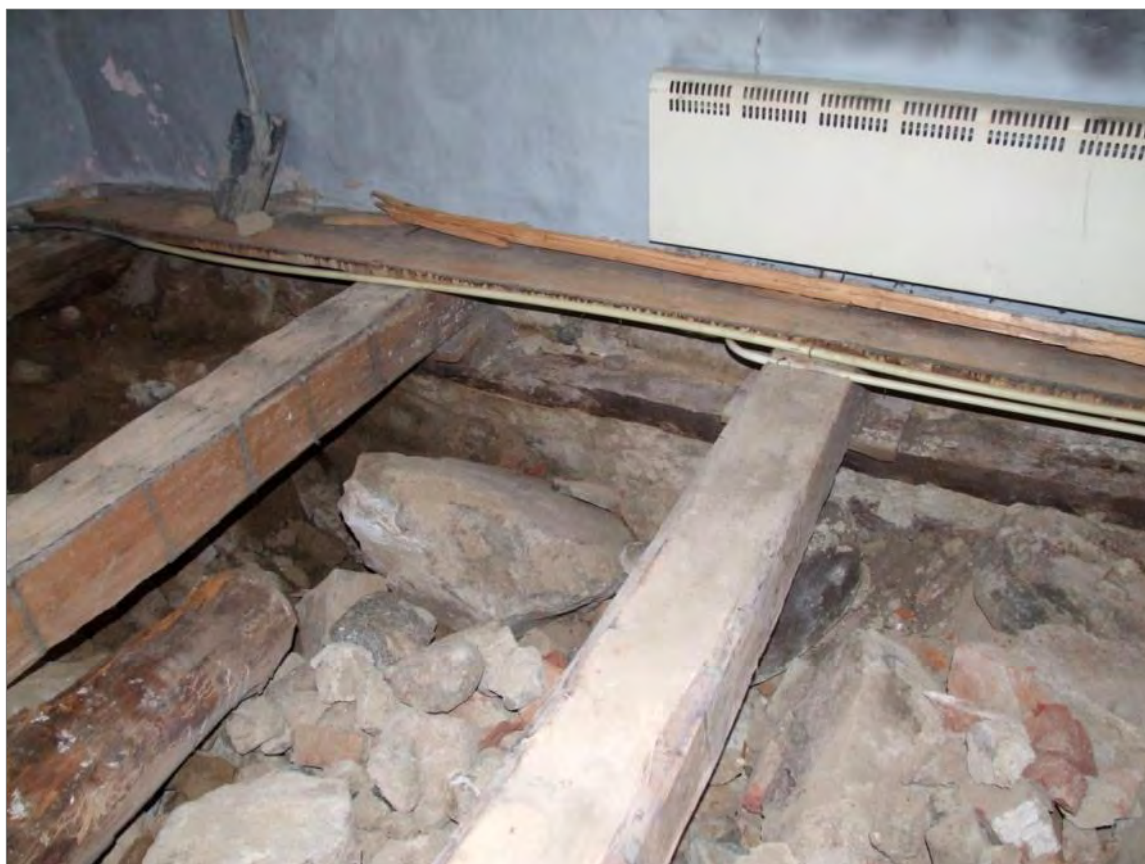
Figur 27. Den äldre sakristians östra källarmur (32) med den längsgående bjälken (31). Foto mot Ö.
