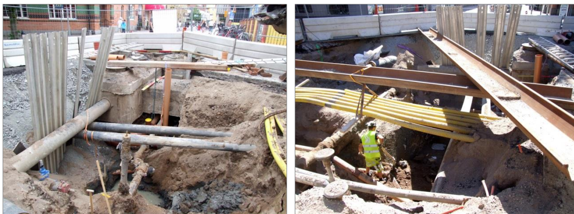
Figur 15 och 16. Korsningen Dragarbrunnsgatan - Smedsgränd juli 2013. Figur 15 fotad mot SV och Smedsgränd. Figur 16 fotad mot SÖ och Dragarbrunnsgatan.
