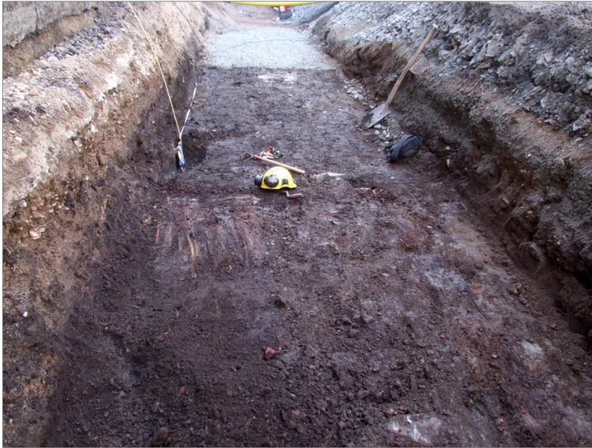
Figur 35. Fjärrvärmeschaktet och södra delen av A8 samt A7 under pågående undersökning. Foto mot SSÖ.
