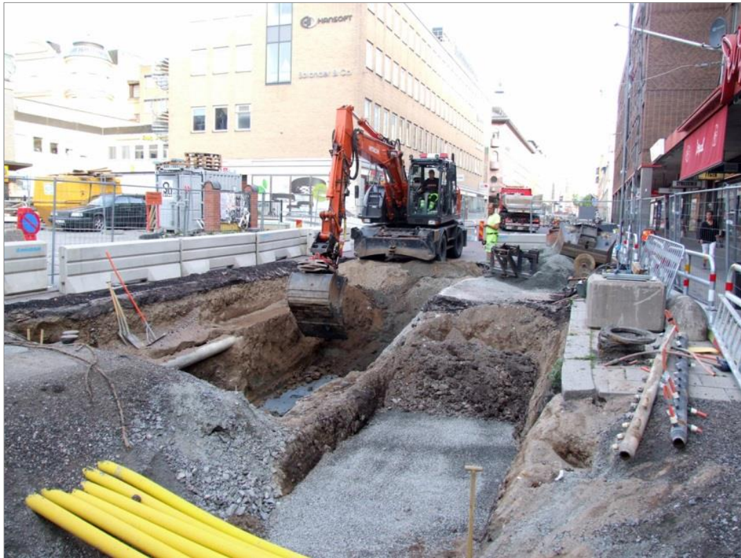
Figur 25. Schaktning i Dragarbrunnsgatan. Det högra schaktet på bilden var avsett för fjärrvärmens och det vänstra för vattenledningar. Foto mot V och Kv. Lejonet.
