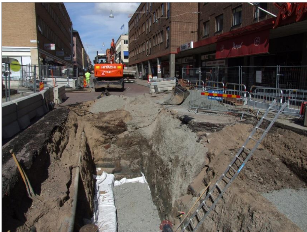
Figur 26. Schaktning i Dragarbrunnsgatan. I bild ses det djupa vattenschaktet till vänster och fjärrvärmeschaktet till höger. Foto mot NV.
