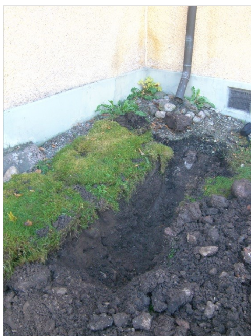
Figur 12. Schakt för att se om lämningar efter det asklager som tidigare påträffats fanns kvar. Foto mot SSÖ.
