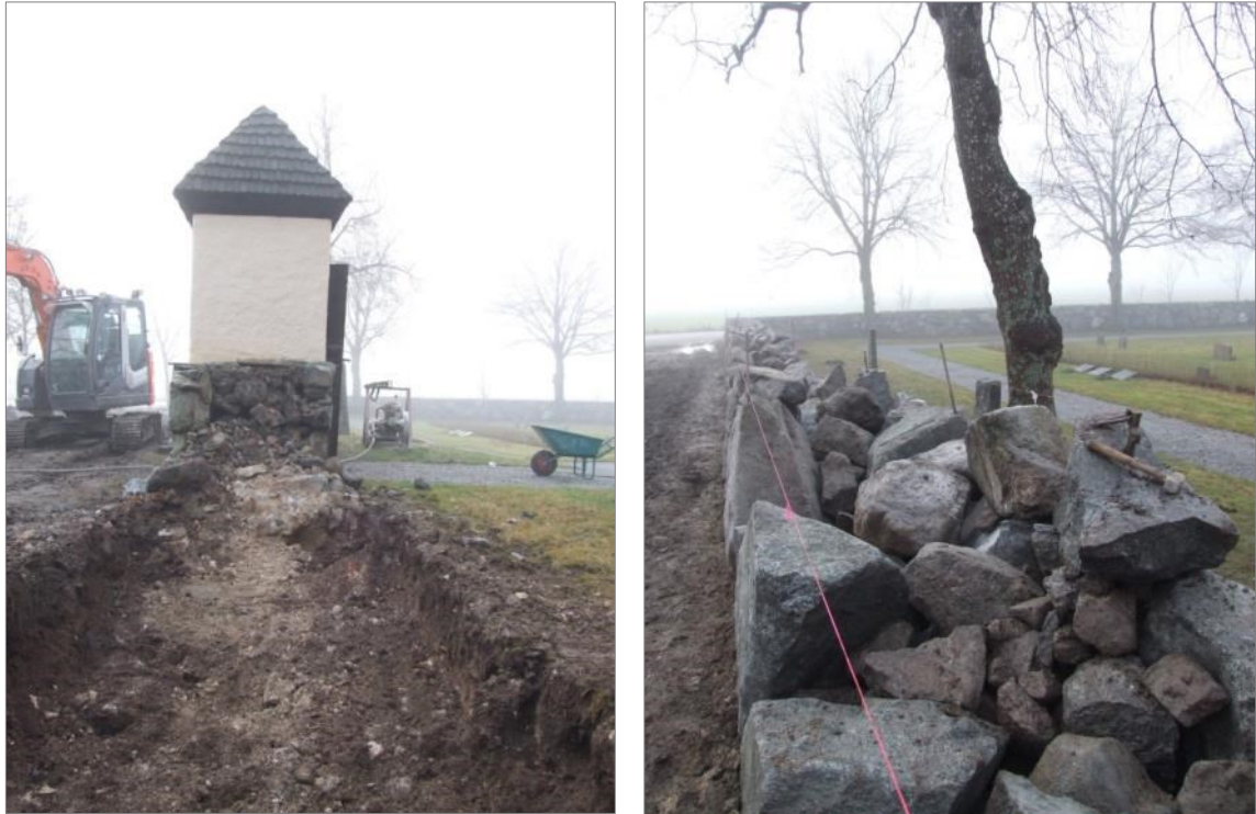
Figur 38 (t.v). Den äldre bogårdsmurens östra del borttogs helt vid arbetet. På bilden framgår att stigluckan är tillkommen senare än bogårdsmuren då partiet närmast stigluckan kallmurats medan resten av muren var varmmurad. Foto mot S.
