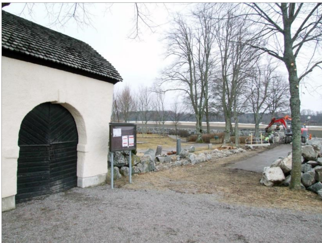
Figur 30. Kyrkogårdsmurens västra del delvis nedmonterad, med den västra stigluckan. Foto mot SSÖ.
