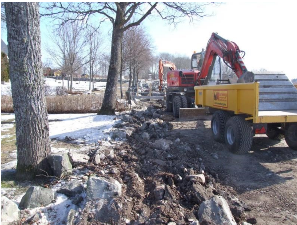
Figur 24. Södra kyrkogårdsmurens västra del nedriven till bottenskiftet av den äldre bogårdsmuren. Parti ca 85 m från SÖ hörnet. Foto mot Ö.
