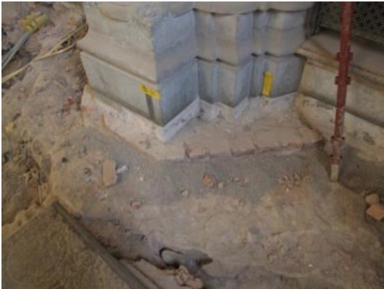
Figur 35. Fundamentet kring pelare D2, med fint lagda tegelstenar på den södra sidan. Foto mot nordost, 2010-01-31.
