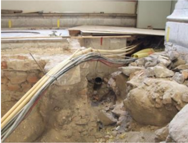
Figur 32. I sydvästra hörnet var störningarna omfattande efter tidigare ingrepp. I bakgrunden syns en gjuten betongkammare för besiktning av avloppsstammen. Därutöver fanns ett större antal elledningar i detta parti. Foto mot söder, 2011-01-31.
