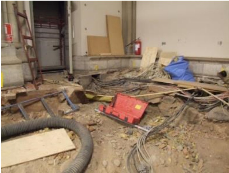
Figur 25. Elledningar intill grundmuren i norr. Vid genomföringen i väster syns att gjutning har skett efter att grundmuren tagits bort. Foto mot nordväst 2011-01-31.
