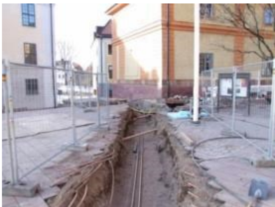
Figur 9. Samma bild som nr 8, men här har de nya sprinklerledningarna lagts på plats. Foto mot nordväst 2011-03-31.
