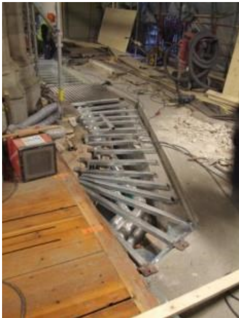
Figur 75. Efter att rör och ledningar placerats i kulverten byggdes en ram inför tillbakaläggningen av golvstenarna. Foto mot väster 2011-02-21.
