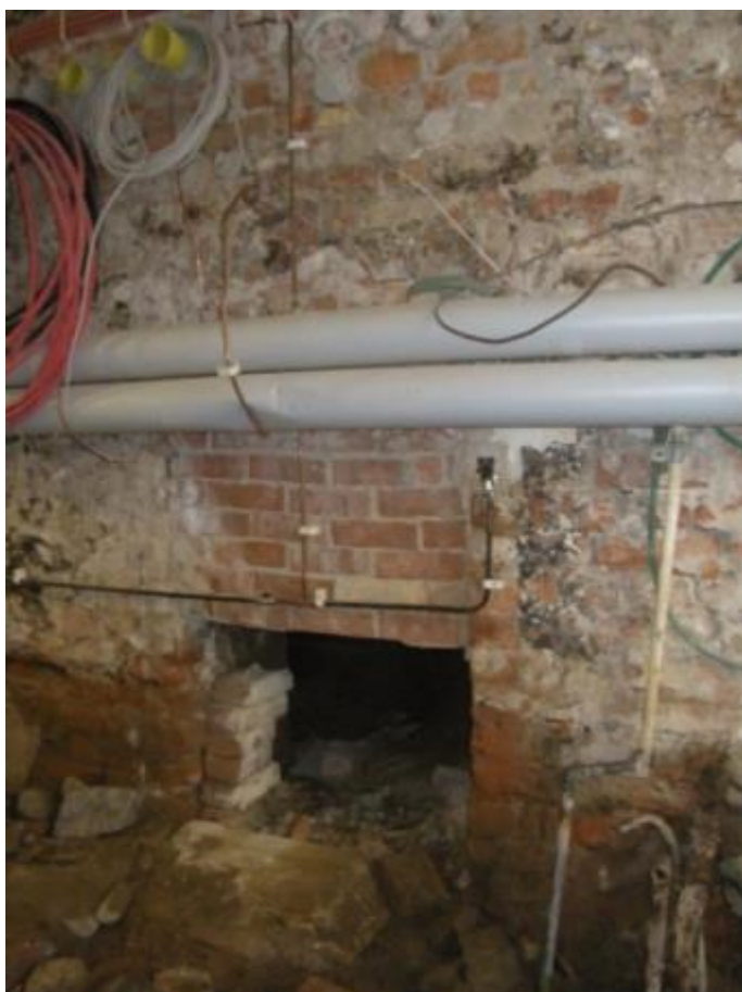
Figur 237. Vid arbetena i utrymmet frilades en öppning i sydvästra väggen. Denna muröppning var igensatt på den del som låg över den ursprungliga golvnivån och i samband med borttagande av golvet framkom en nedre öppning in mot källaren. Foto mot söder 2010-09-21.
