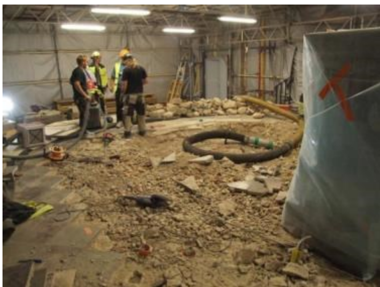
Figur 157. I likhet med övriga arbeten i kyrkan var torrsug kopplad till en sugbil det viktigaste arbetsredskapet. Här har arbeten precis påbörjats efter att golvet tagits bort. Foto mot nordväst 2011-06-21.
