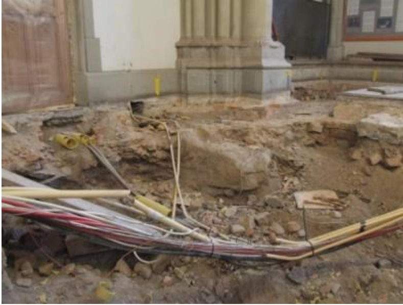
Figur 34. Foto mot pelare D2 från nordväst. Strax bakom ledningsdragningen syns den kraftiga stenen i fundamentet till pelaren. Foto mot sydost 2010-01-31.
