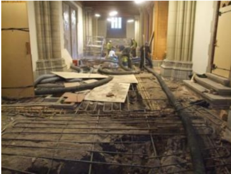
Figur 18. Schaktningsarbeten påbörjade i förhallen i slutet av januari 2011. De mesta fyllnadsmassorna sögs ut med en större industridammsugare. Kvar under det borttagna stengolvet syns rören från den äldre golvvärmen. Foto mot söder 2011-01-24.
