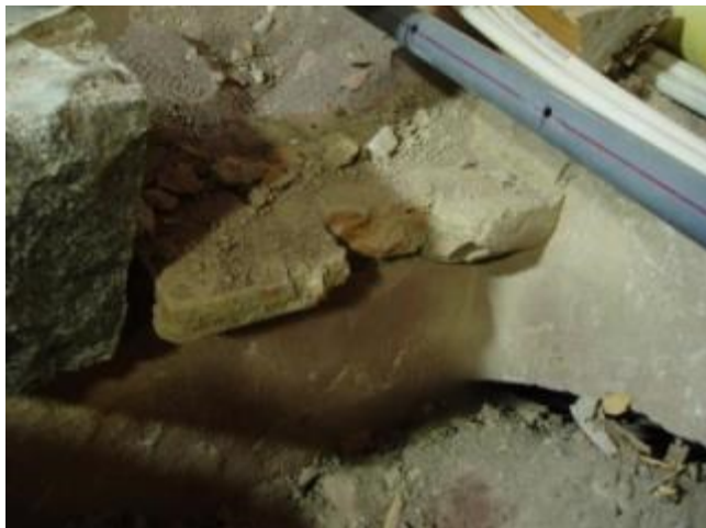
Figur 91. Stöd för tidigare häll som legat ovan öppningen till kammare B, i dess sydöstra hörn. Foto mot öster 2010-11-11.
