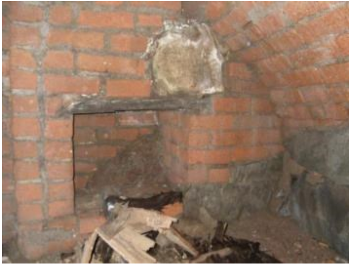
Figur 244. Detalj av nischen i norra kortsidan, öster om ingången till källaren. Foto 2010-09-21.
