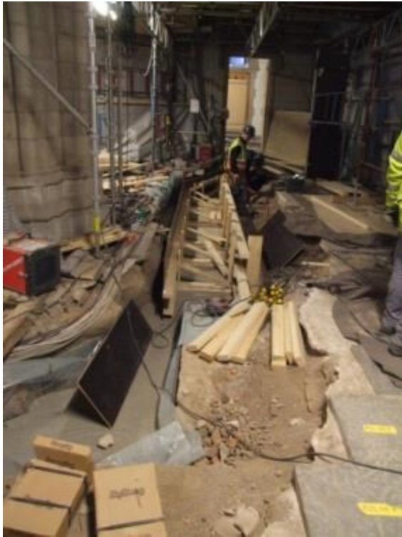
Figur 72. Byggande av formen till kulverten i västra delen av norra sidoskeppet. I bakgrunden syns dörren in till förhallen. Foto mot väster 2011-02-03.
