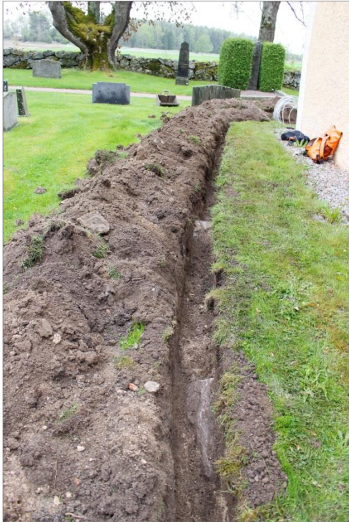
Figur 9. Vid korets norra gavel påträffades i schaktet två stenar, C. Vid dessa fanns även rester av kalkbruk. Foto mot S.
