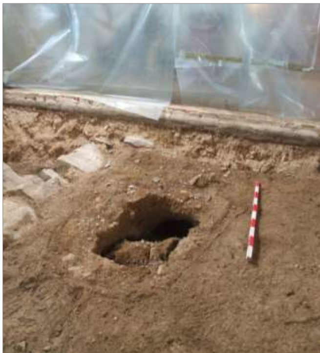
Figur 16. Grav som skapat underminerad yta på norra sidans östra del. Foto mot NNÖ.
