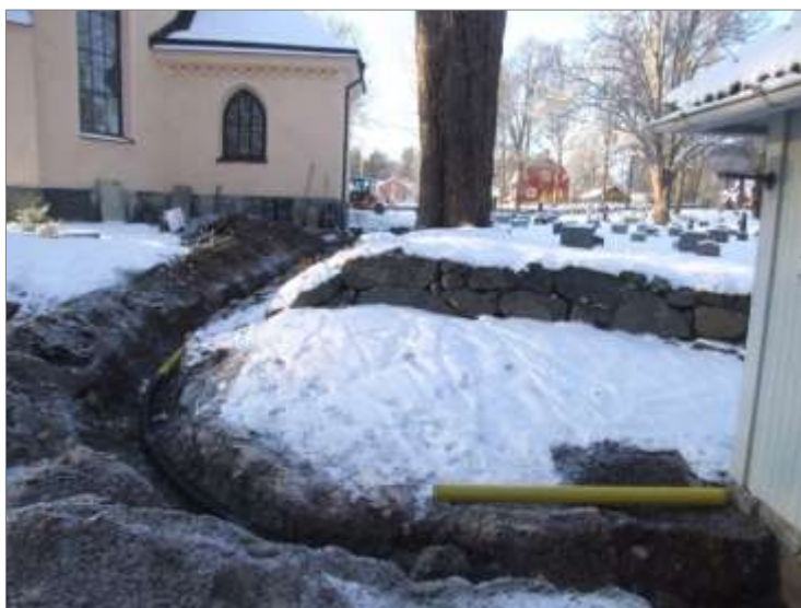
Figur 23. Elschakt för huvudledning vid bårhuset till höger. Foto mot V.
