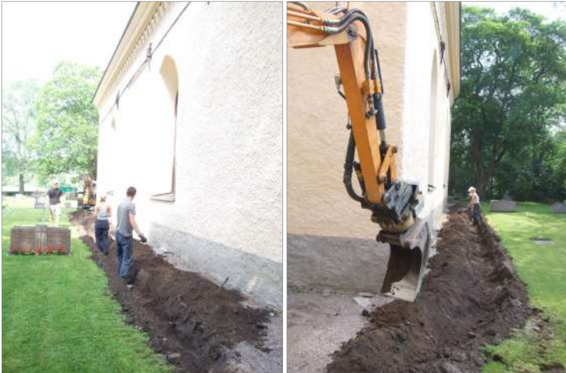
Figur 27. Schakt för ringledare/åskskydd längsmed södra fasaden. Foto mot V. Figur 28. Schakt för ringledare/åskskydd längsmed södra fasaden. Foto mot Ö.
