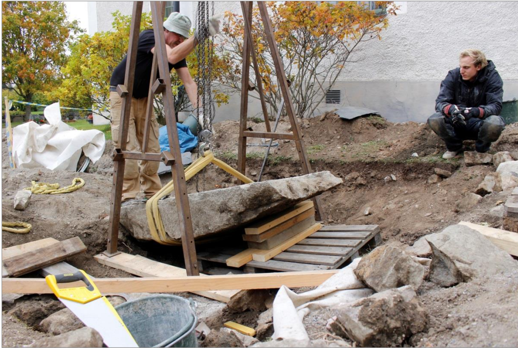
Figur 32. Runstenen hissades stegvis upp och stöttades upp av lastpallar och plankor. Foto mot NV.
