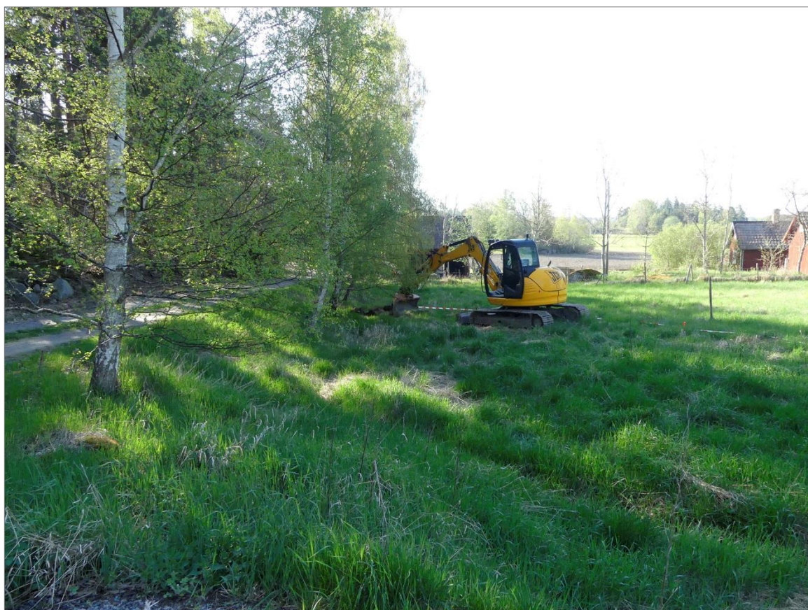
Figur 5. Grävmaskinen innan påbörjad schaktning för anläggande av ny tillfartsväg. Foto mot SÖ.
