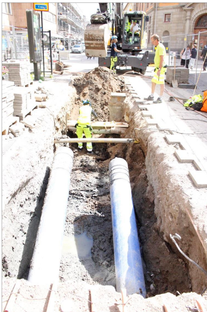
Figur 7. Pågående schaktning i Kungsgårdsgatan, direkt nordväst om korsningen med Bangårdsgatan. Foto mot SÖ.
