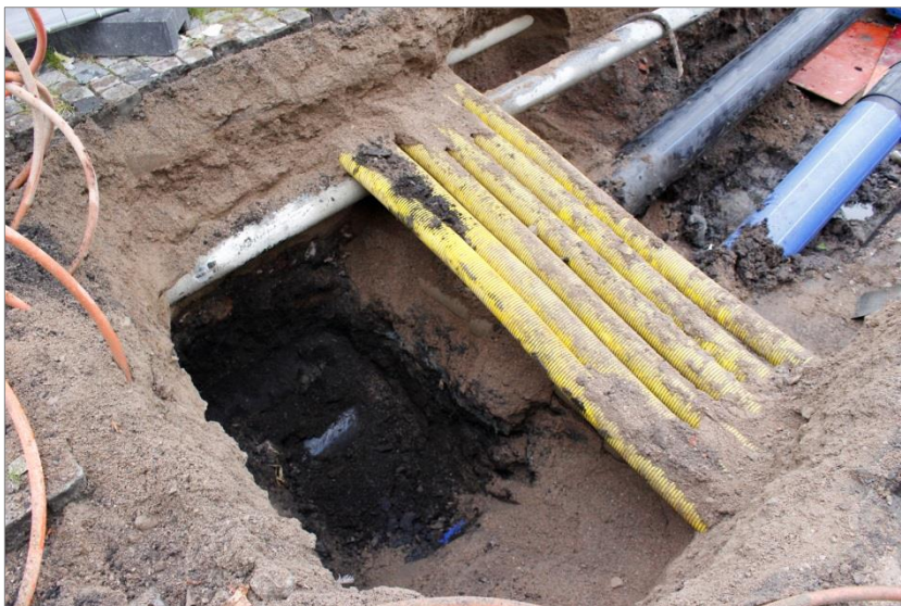
Figur 35. I etapp 3 fanns flera ledningar på olika nivåer och först mot schaktets botten fanns ett bevarat kulturlager. Detta liknade de träflislager som dokumenterats mot botten i etapp 1 och etapp 2.
