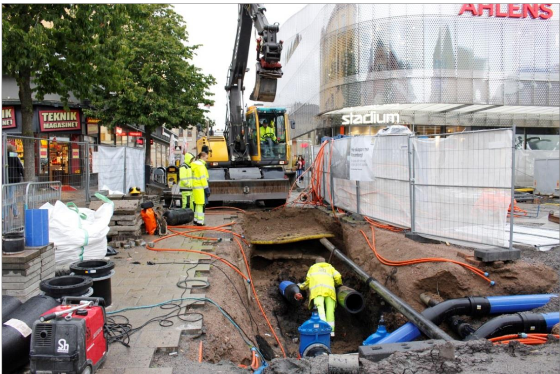
Figur 11. Pågående schaktning och koppling av nya ledningar i schakt 1 som grävdes längs med Forumtorget. Foto mot NV.
