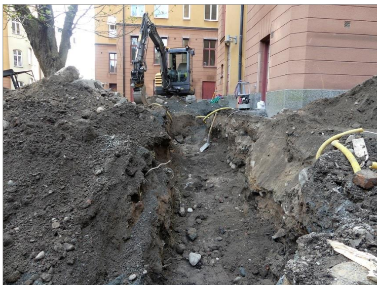
Figur 20. Schakt för spillvatten med stenläggning A3 synlig i södra schaktkanten och A4 centralt i schaktet. Foto mot Ö, Emelie Sunding Upplandsmuseet.
