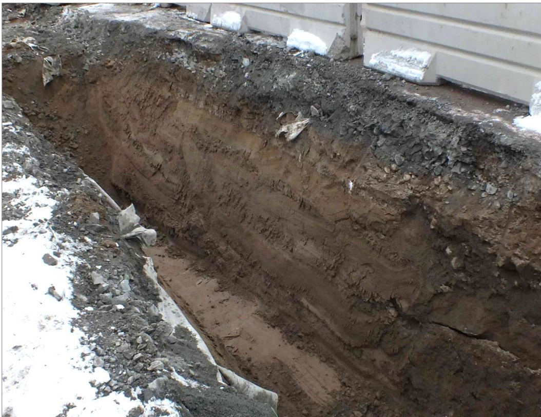
Figur 12. I det västra schaktet fanns under asfalten omrörd fyllning. Därunder kunde ett naturligt avsatt ljust lerlager samt tjocka sandlager ses. Mot NV.
