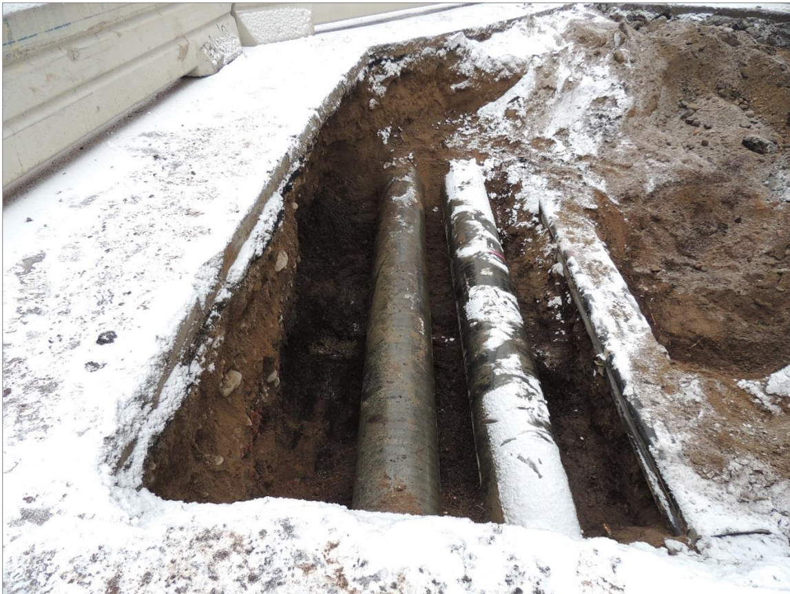
Figur 14. Schaktet vid brofästet i korsningen S:t Olofsgatan- Östra Ågatan. Under ledningarna påträffades träkonstruktion 1. Foto mot NO, Robin Lucas Upplandsmuseet.
