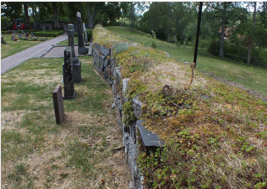
Figur 14. Före renoveringen framgick att den södra delen av muren har en knyck och är något indragen mot öster. Foto mot S.
