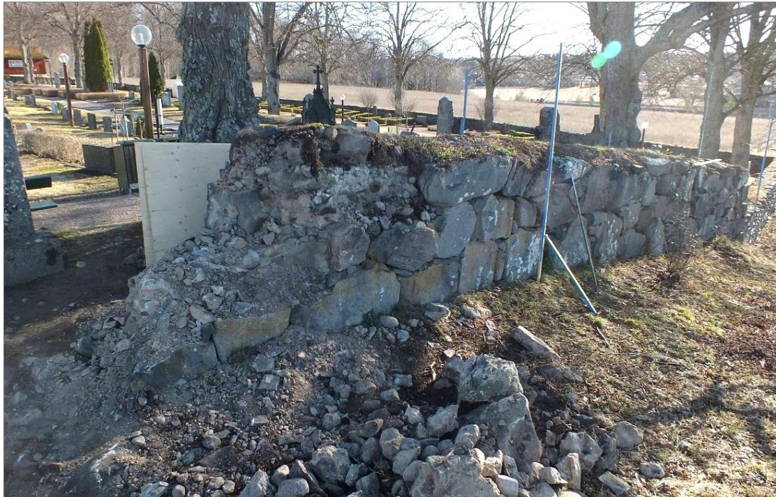
Figur 17. På södra sidan bestod skalmurens fyllning av murbruk och mindre stenar, här visas den östra delen. Foto mot NÖ.
