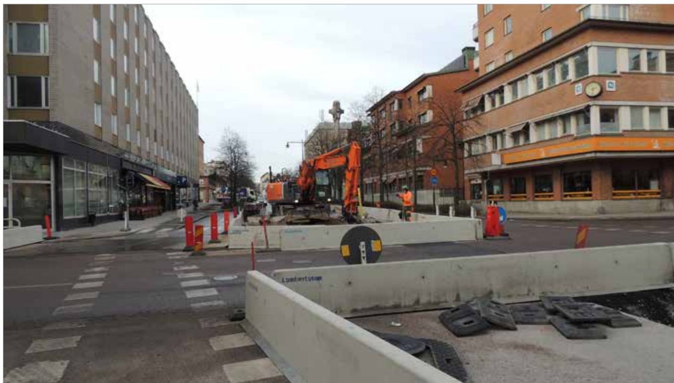
Figur 18. Schakt 5 i S:t Olofsgatan, närmast korsningen mot Kungsgatan. Foto mot sydväst, Linda Qviström/Upplandsmuseet.
