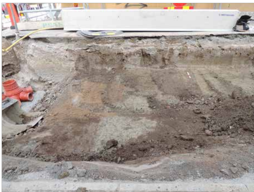
Figur 95. De troliga odlingsbäddarna A28 och A29 i plan, under pågående schaktning. Dokumentationen försvårades av att grävmaskinen i den här änden av schaktet var tvungen att stå på snedden för att komma åt. Grävarbetet var dessutom tvunget att skyndas på eftersom fordonen delvis hindrade den passerande trafiken. Foto mot nordväst, Linda Qviström/Upplandsmuseet.
