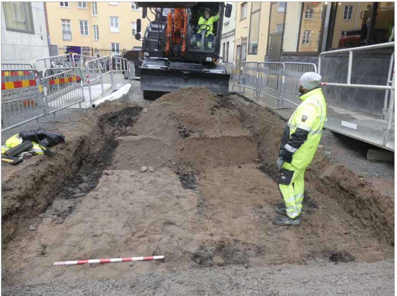
Figur 54. Läget för schakt 14 med de få bevarade strimmorna av kulturlager, L. 1, synliga. Foto mot V, Malin Lucas.
