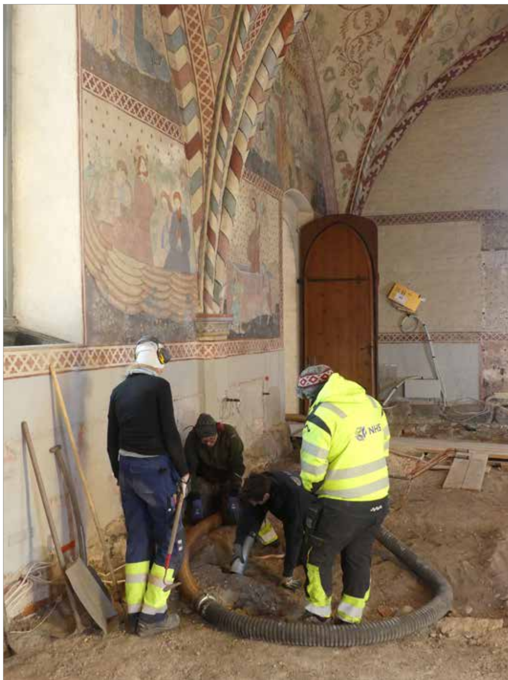
Figur 6. Jordmassor avlägsnas med hjälp av sugbil under övervakning. Foto mot V, Karin Stenström.
