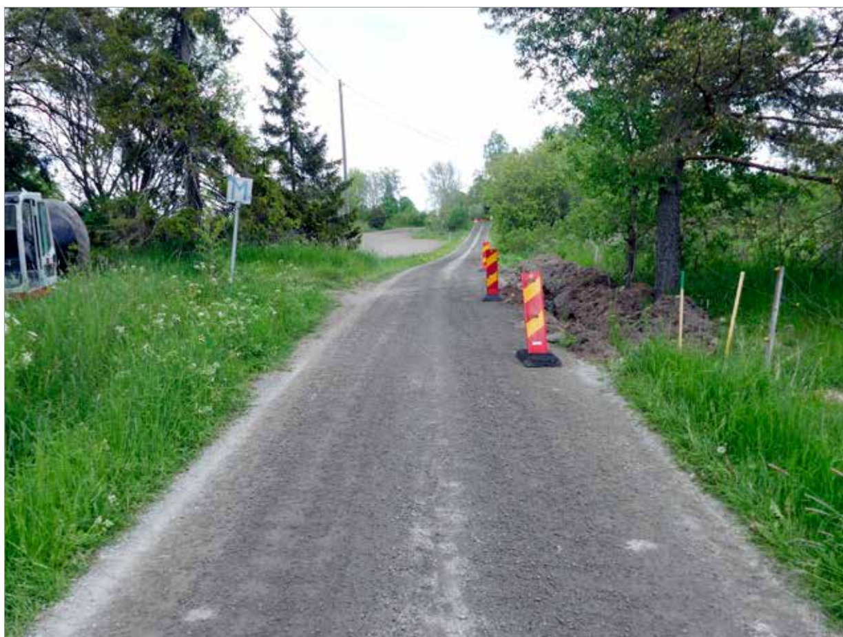
Figur 11. Vid delsträcka 3 grävdes kabelschaktet i den östra kanten av en grusväg. Foto mot norr, Hans Göthberg, Upplandsmuseet.
