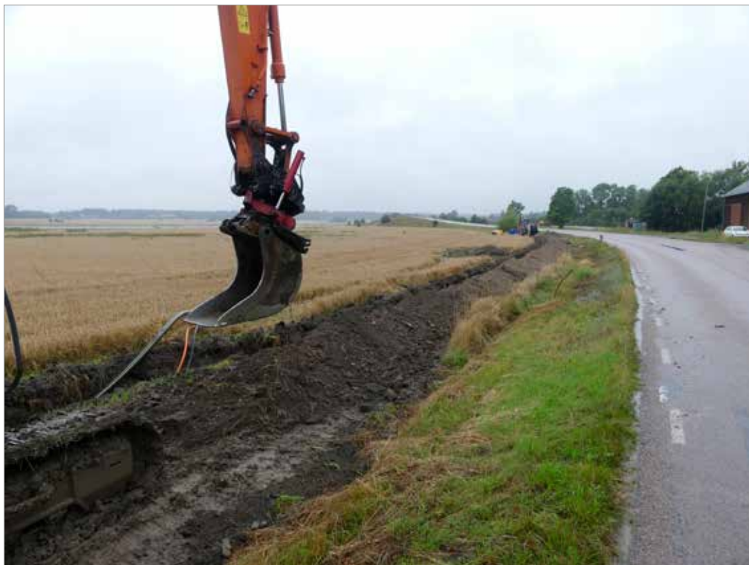
Figur 29. Schaktet inom delsträcka 9 grävdes i åkerkant mot väg. Ytan under vägen undersöktes 2002 där två stolphus identifierades mitt för det övervakade schaktet. Foto mot nordväst, Hans Göthberg, Upplandsmuseet.
