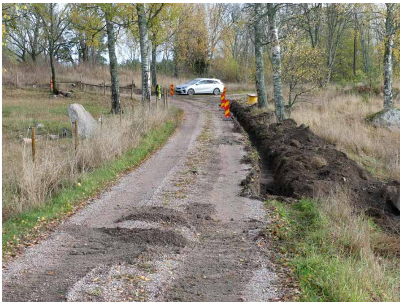
Figur 20. Schaktgrävning vid Ingla. Till vänster ses U 885. Foto fr. SV: Hans Göthberg.
