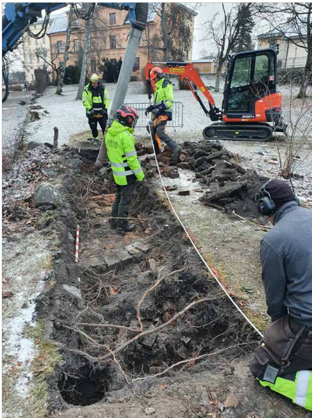
Figur 7. Pågående rotinspektion parallellt med arkeologisk dokumentation i schaktets södra del. Foto mot sydväst. Foto: Joakim Kjellberg, Upplandsmuseet.
