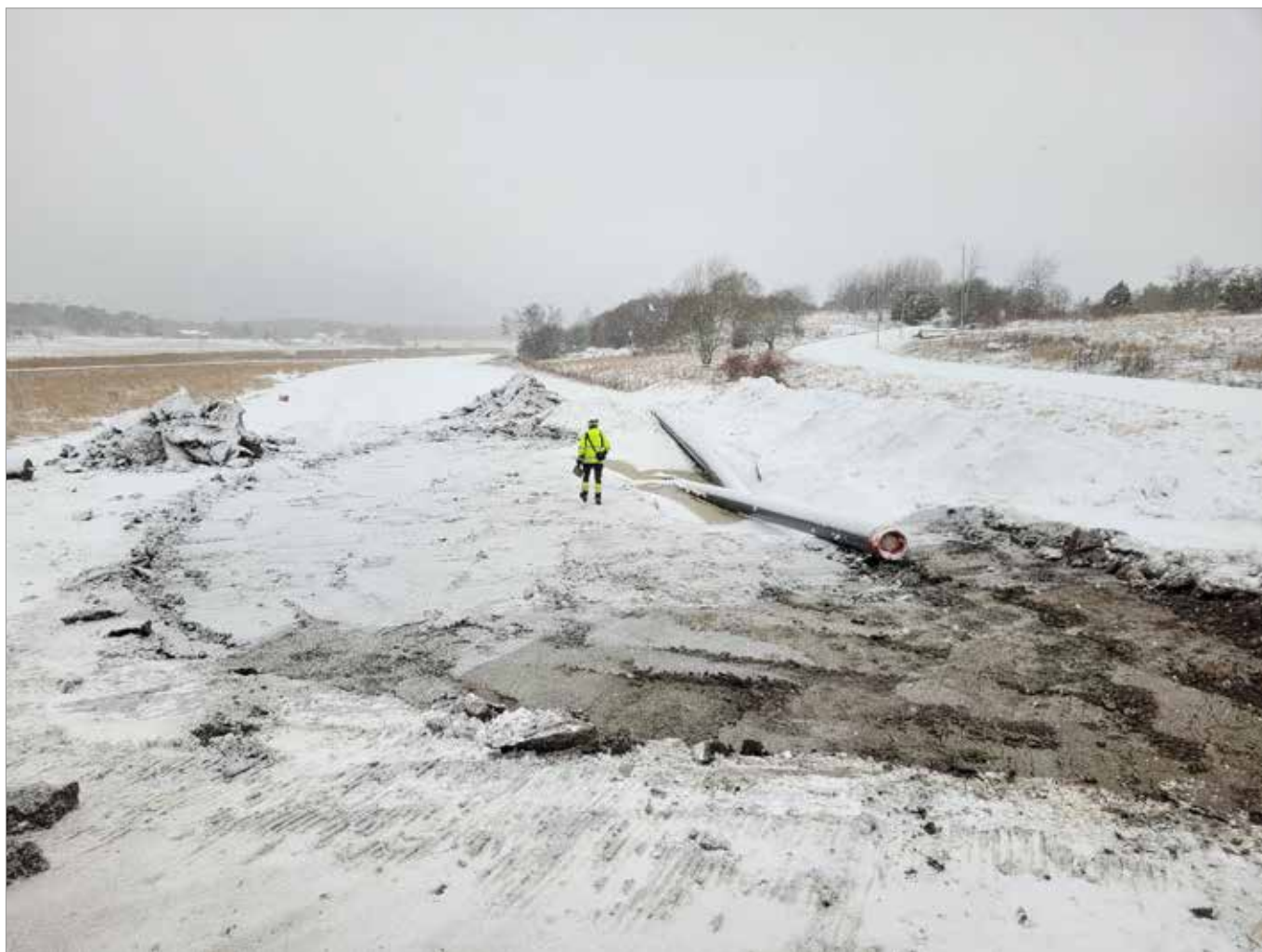
Figur 13. Avbaningen av schakt 4 inom Område C skedde i snöyra. Foto mot nordväst, Robin Lucas, Upplandsmuseet.
