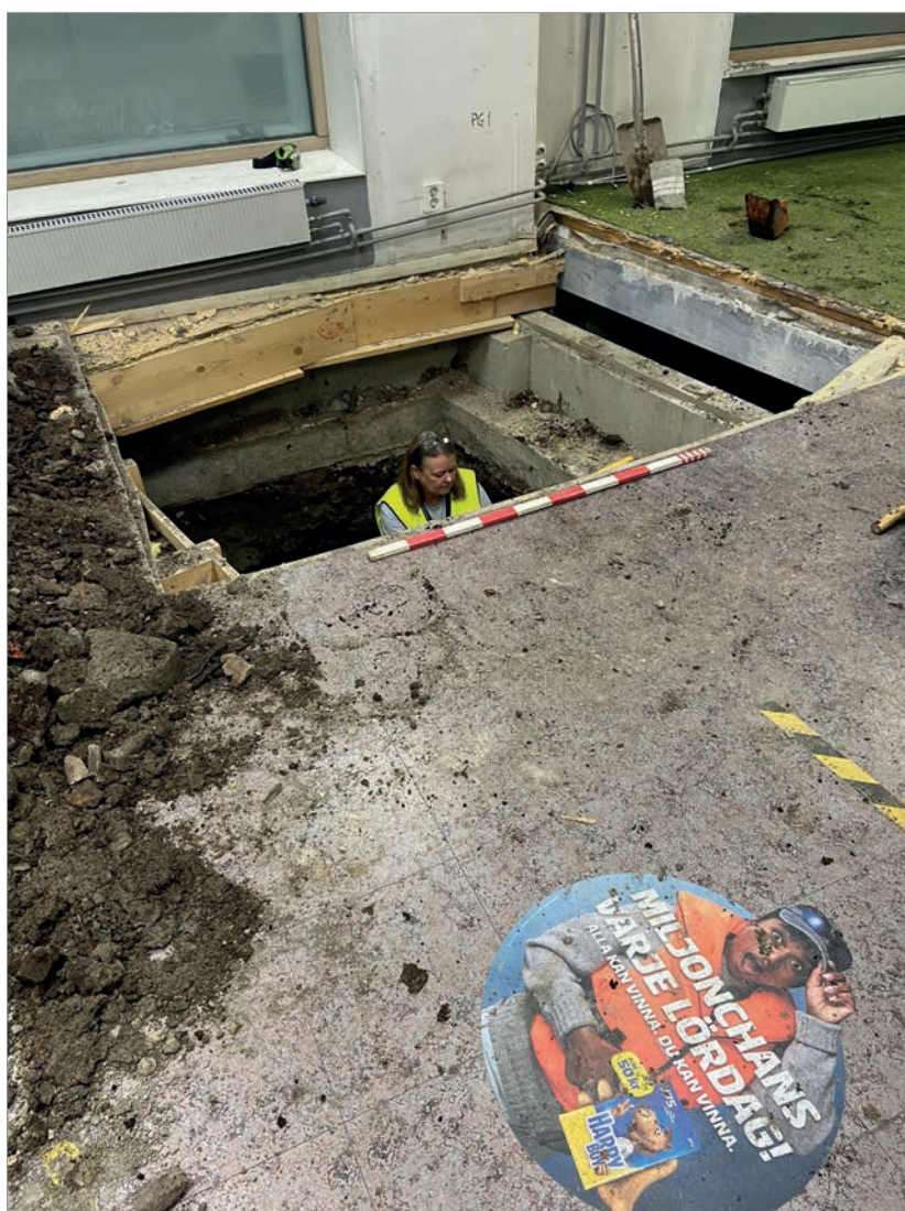
Figur 1. Schaktningsövervakningen gjordes under golvet i en före detta spelbutik. Foto Anna Ölund.
