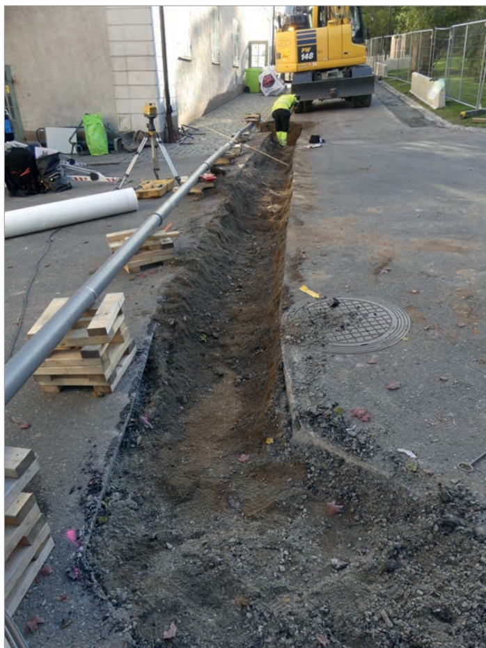
Figur 25. Schakt C. Murresten (objekt 45) i bortre änden av schaktet. Foto mot söder, Robin Lucas, Upplandsmuseet
