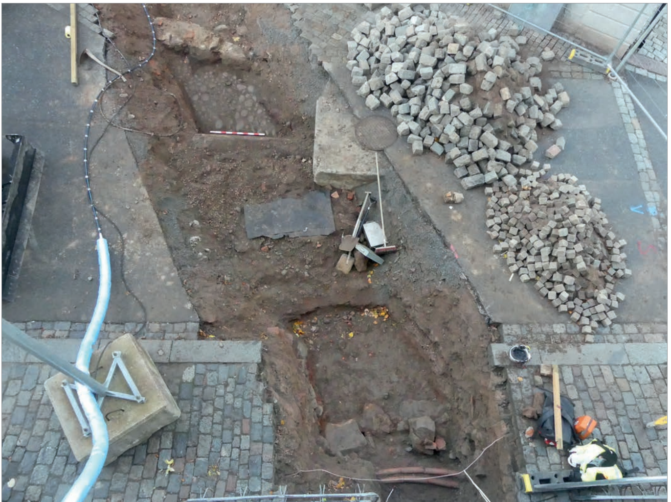
Figur 9. Översikt av Schakt A. Längst ner i bild finns de undre delarna av den skadade yttermuren (objekt 5) i hus 1. I mitten av schaktet finns nedgrävning för den gamla värmekulverten och ovanför denna stenpackningen (objekt 25) för gatan. I bildens övre kant finns den kraftiga muren till hus 2. Foto, Robin Lucas, Upplandsmuseet.
